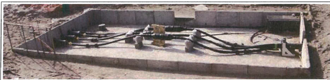
Figure 7 : Chambre de jonction d'atterrage
